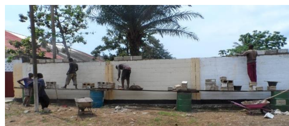
buitenmuren worden verhoogd en verstevigd/elever les murs et placer des grilles pour la sécurité
