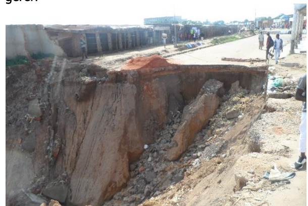
la rue 's'effondre/ de straat is ingestort
