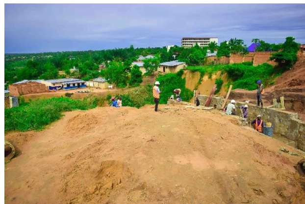
Ravin av. Tshisekedi en entretien / ravijn in onderhoud aan de Tshisekedilaan
