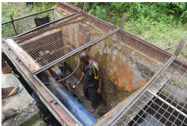
de oude installatie/l' ancienne installation
