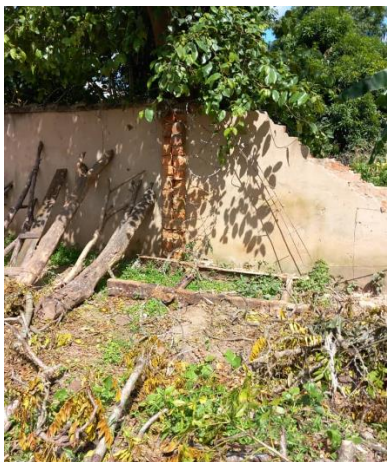
Ingestorte muur/Un mur effondré
