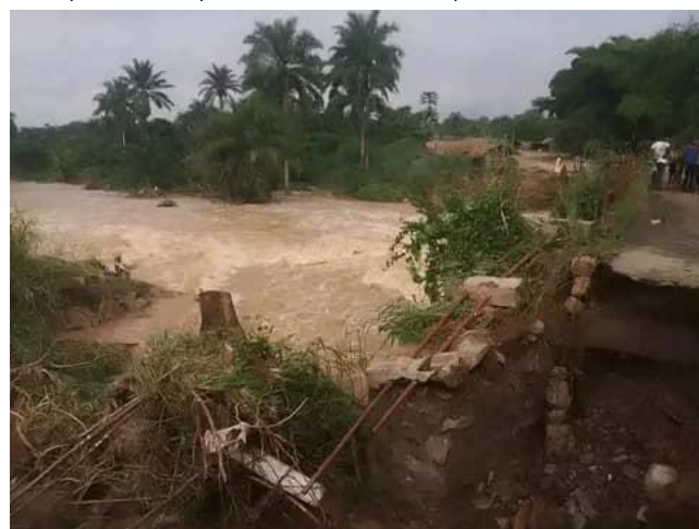
effondrement du pont / ingestortte brug
